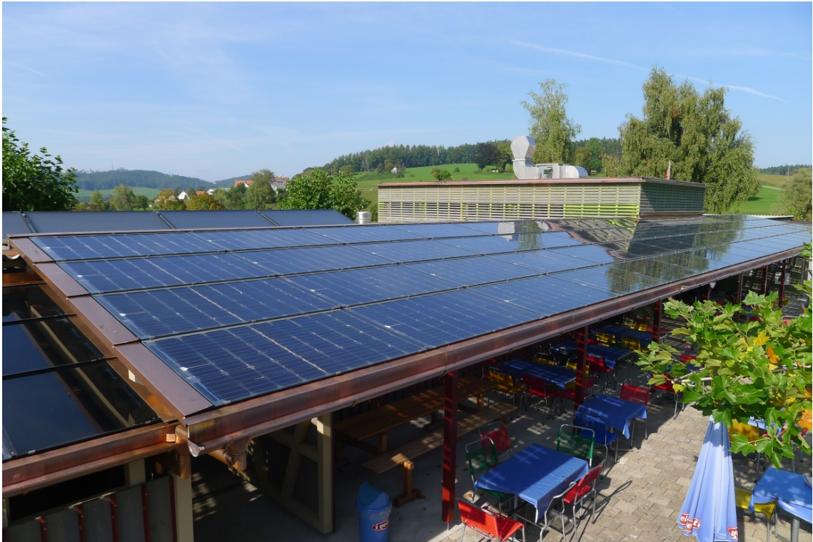
PV-Anlage der EG Elgg auf dem Dach des Schwimmbads Elgg mit semitransparenten Modulen
