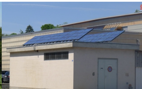
Trafostation St. Gallerstrasse
